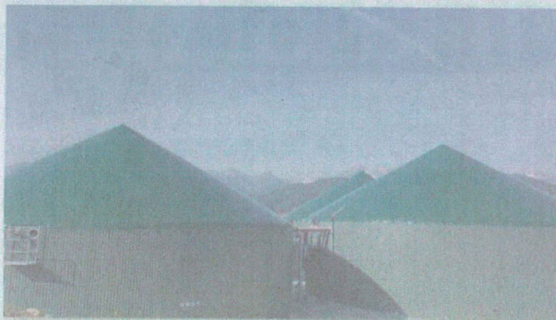
I DIGESTORI per poi ricavare energia elettrica dal biogas
